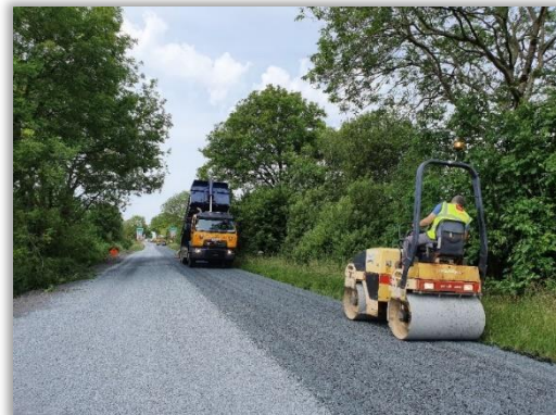
Oibreacha Cóirithe Dromchla ar an N63 ag Barr na Cora i mBaile Uí Mhatháin MD
